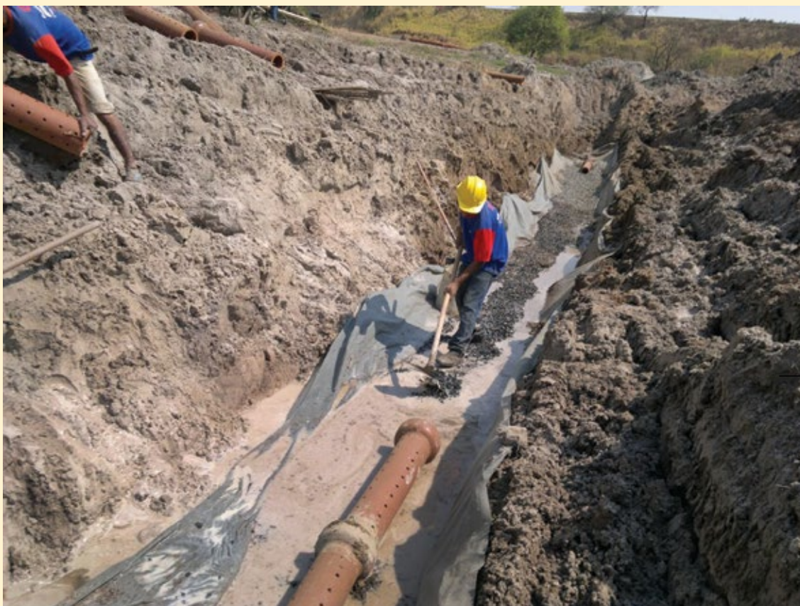
Drenagem subterrânea, uma das técnicas utilizadas no manejo do solo-água-planta
