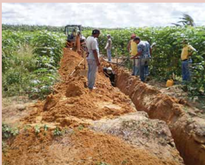
Drenagem subterrânea no Perímetro Irrigado Fulgêncio, PE
