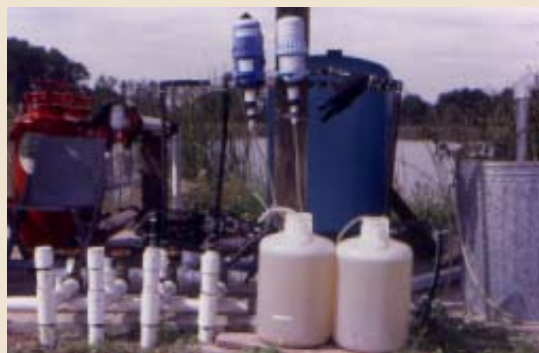
Sistema de injeção de fertilizantes automatizado, com solução estoque
