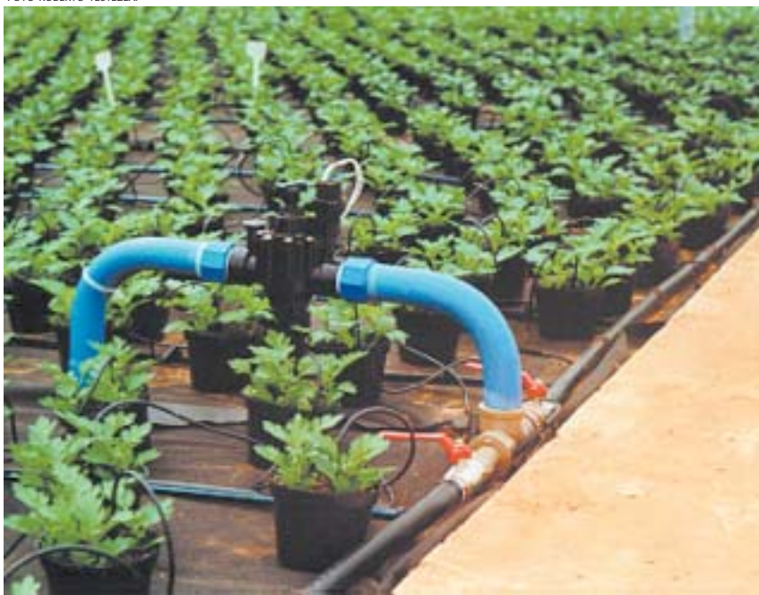
FIGURA 2 – Válvula automática que permite o controle para diferentes setores na estufa
