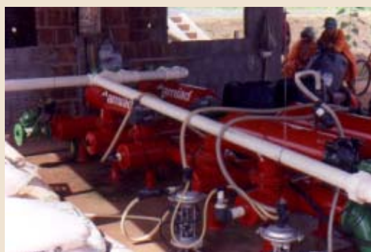
Instalação de Injeção de fertilizantes com bombas injetoras e filtros
