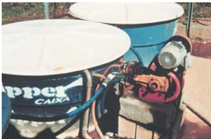
FIGURA 3 – Sistema de fertirrigação com bomba injetora tipo pistão
