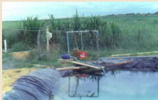
Pequena instalação de fertirrigação utilizando injetor Venturi
