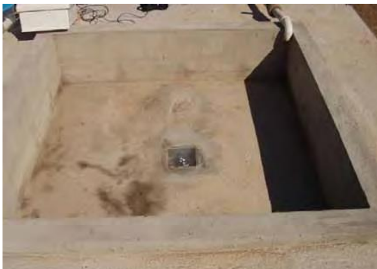
Figura 1. Reator solar quadrado para desinfecção de efluente doméstico (SÁNCHEZ ROMÁN et al. , 2007).
