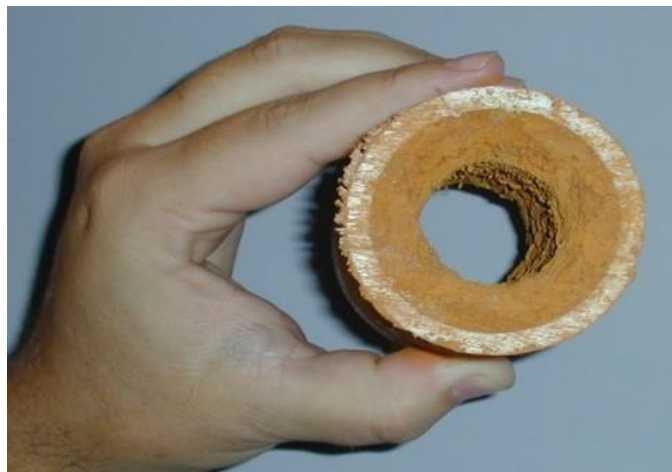
Figura 11. Entupimento por precipitados de ferro.
